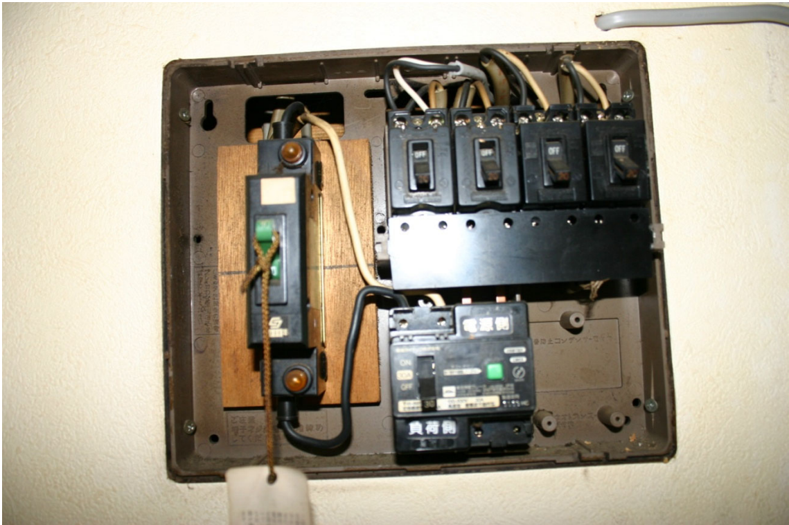
電力設備(30A)
